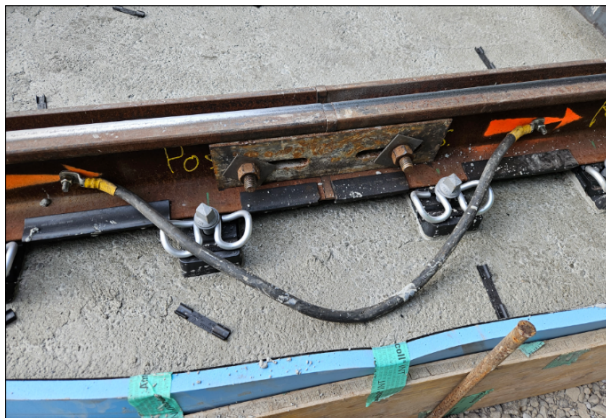
Abbildung 5: So nicht, Betonoberfläche ohne Aussparung im Bereich des Schweisstosses
