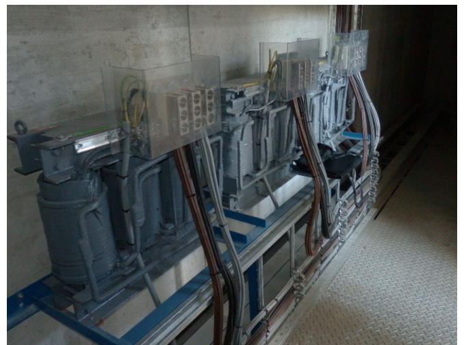
Abbildung 42: 40V Transformatoren Belagsheizung Hiltalingerbrücke
