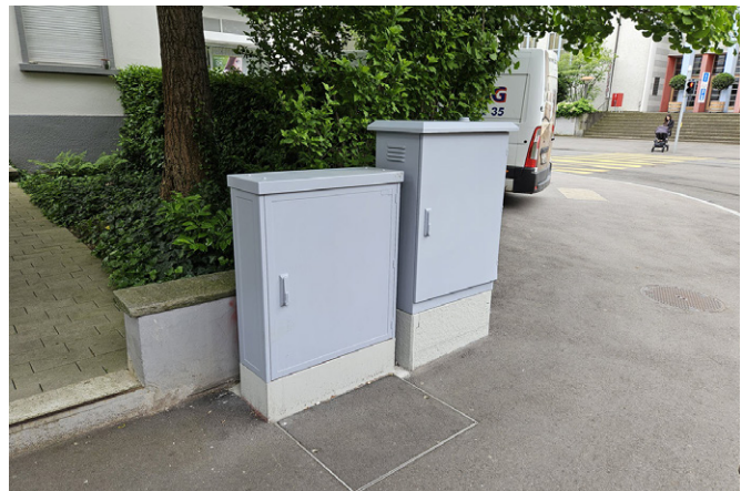
Abbildung 39: Schmieranlagensteuerung und Elektroverteilung Zwinglihaus
