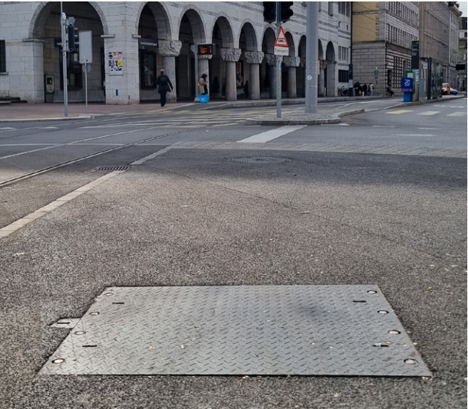
Abbildung 38: Bodenkasten der Schmieranlagensteuerung Nr. 85 beim Kunstmuseum
