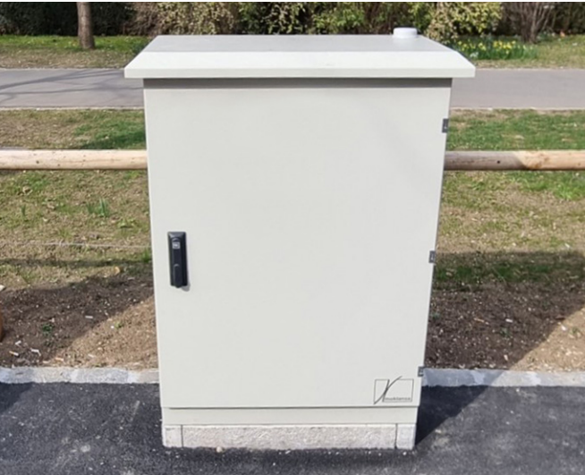
Abbildung 39: Schmieranlagensteuerung an der Haltstelle Hardstrasse
