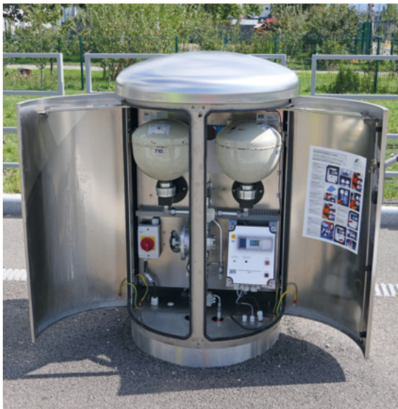
Schmieranlagensteuerung Nr. 63 vor der Haltestelle Saint-Exupéry in Fahrtrichtung Burgfelderhof
