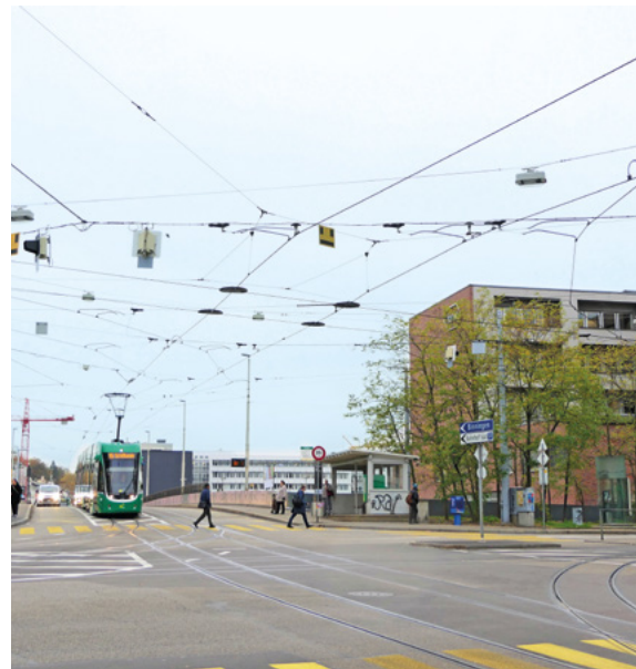
Fahrleitungsanlage Kreuzung Markthalle Blickrichtung Gundeli (Südwest)
