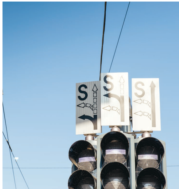
Fahrleitung und Lichtsignalanlage
